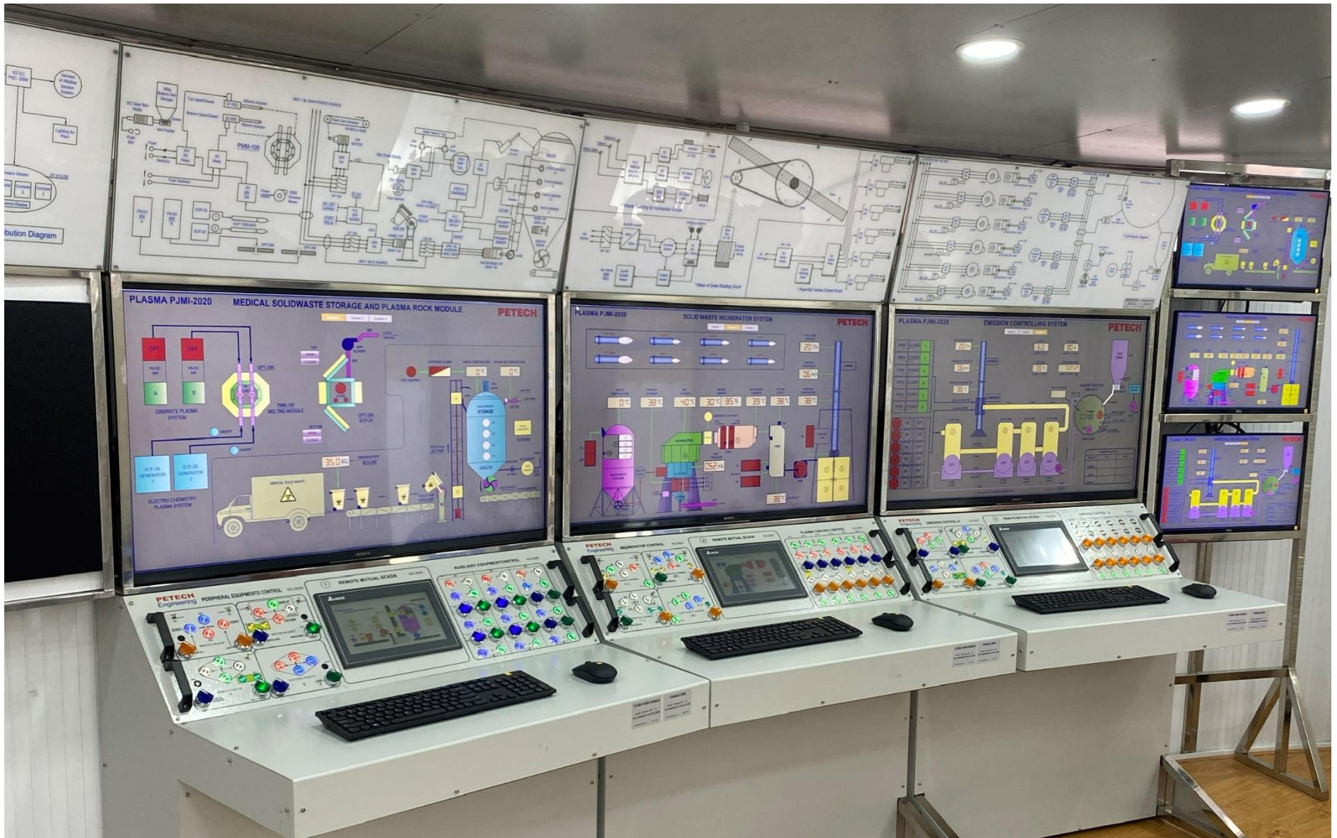
Hệ thống RmS, giám sát và điều khiển tự động, nhà máy xử lý rác Plasma (2022). Monitoring and automatic operation room (2022).
