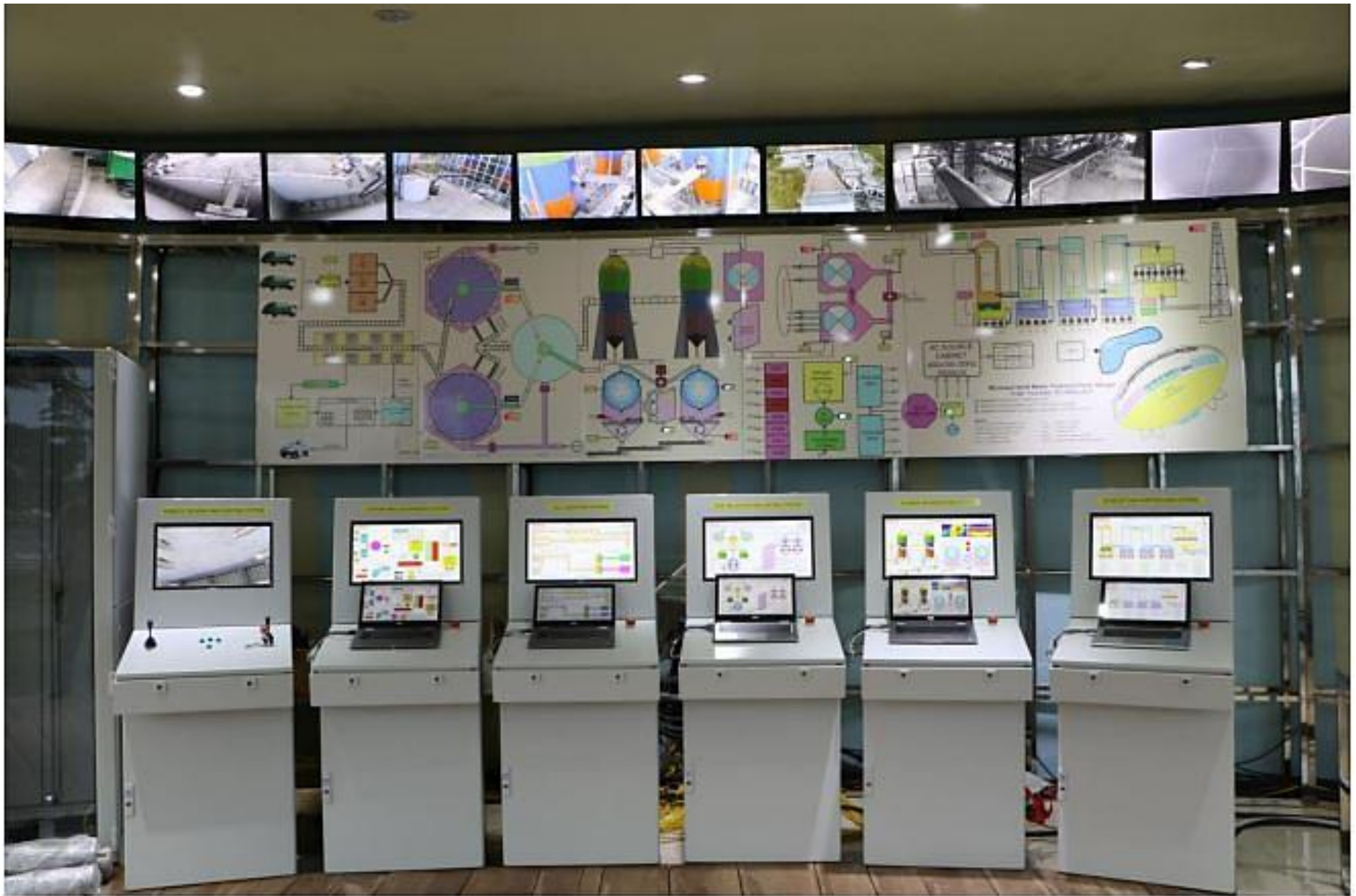
Hệ thống RmS, giám sát điều khiển và vận hành tự động, nhà máy xử lý rác Plasma (2016). Monitoring and automatic operation room (2016).
