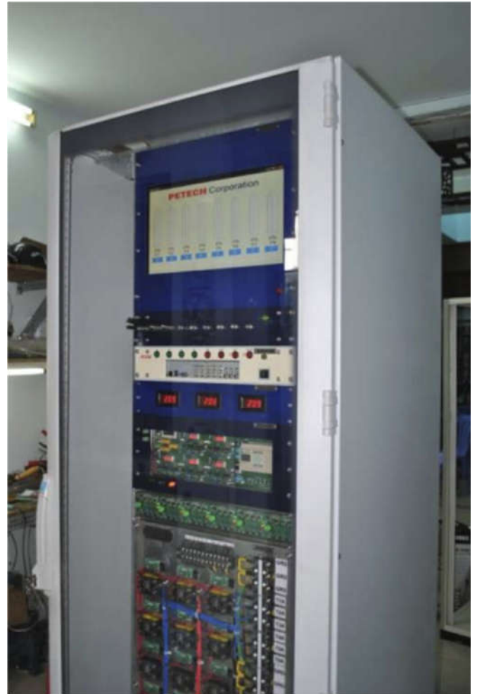
HỆ THỐNG SCADA-RMS 300
