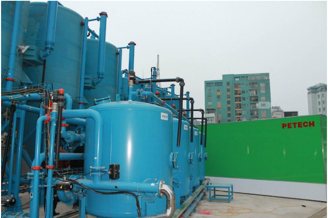
HT Xử lý Nước thải thành Nước Uống (Hawaco), Yên Phụ, Hà Nội (2010).
