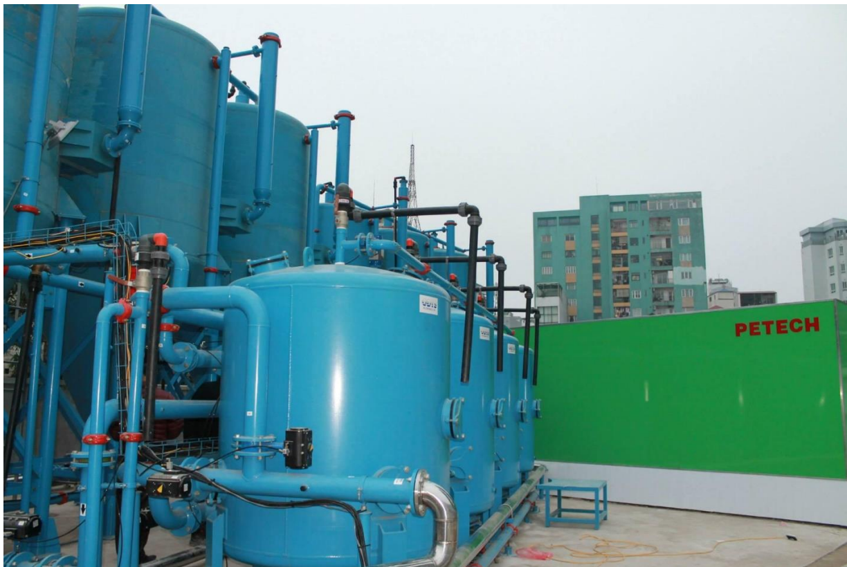
Hình 5: Hệ thống XLNT 2400 m 3 /ngày do Petech cung cấp và lắp đặt đã đưa vào vận hành tại Nhà máy nước Yên Phụ - Hawaco, quận Ba Đình - Hà Nội (năm 2014).
